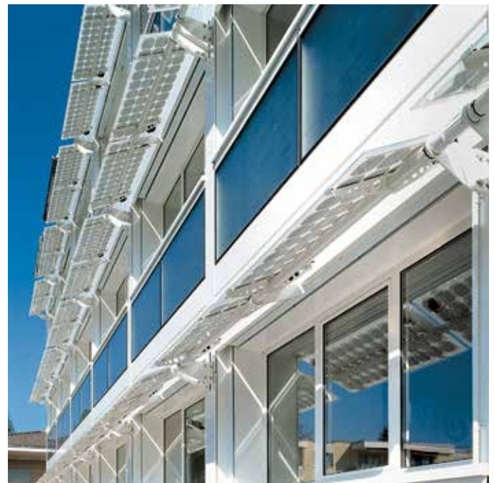
Aluminiumfenster, Brüstungen mit Sonnenkollektoren, Beschattung mit Photovoltaik-Zellen Verbandssitz der Tessiner Wirte, Lugano
