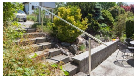
Einfamilienhaus in Hedingen Einseitiger Handlauf
